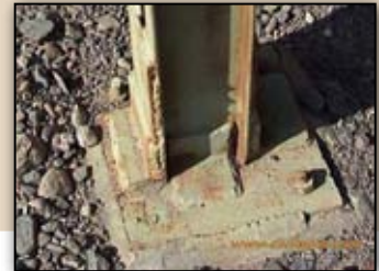
شکل ۲- استقرار نامناسب ستون بر روی کف ستون
