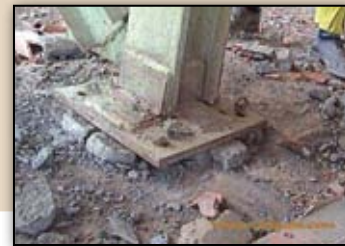
شکل ۴- کوتاه بودن طول رزوه در میله مهار و پارگی میله مهار
